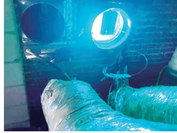
兩個掉落地上的巨大冷暖氣輸送管接口
