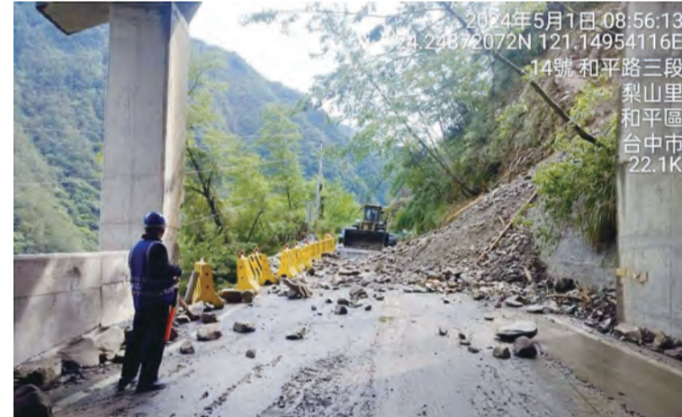
中橫便道17.8k崩塌清理中，今視天候路況決定是否開通。
