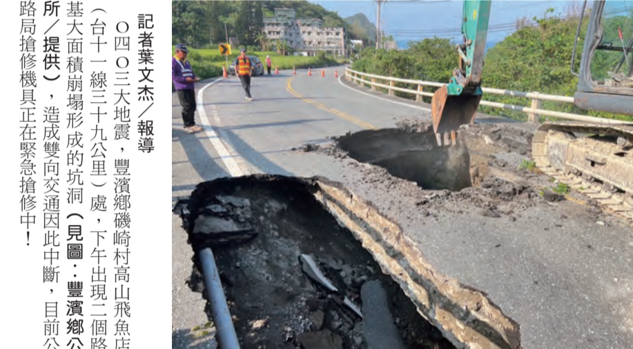
台11線磯崎路基崩塌，雙向交通斷。
